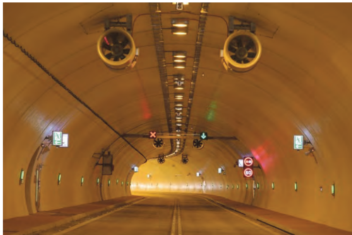
شکل ۱۸- تهویه‌های هوای نصب شده در تونل
